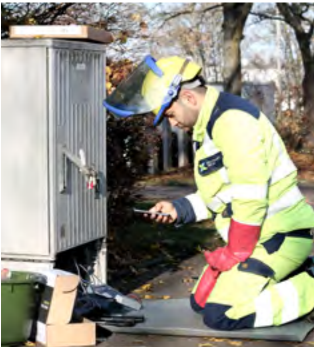
Stuttgart Netze: Messtechnik in Kabelverteilerschränken hilft bei der Fehlersuche.
