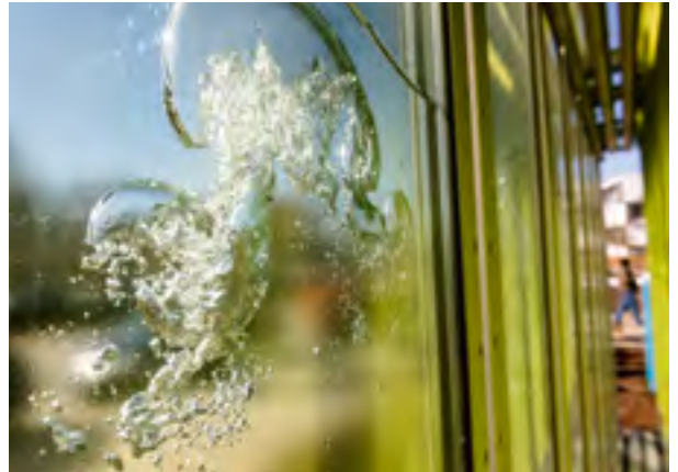
Photobiokollektoren in der Fassade des BIQ Algenhauses.
