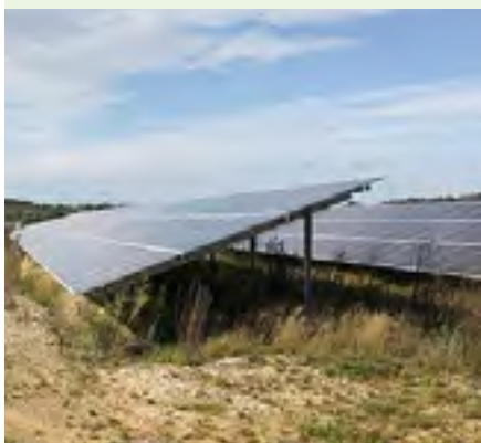
Der Solarpark Kersch kurz vor der Fertigstellung.
