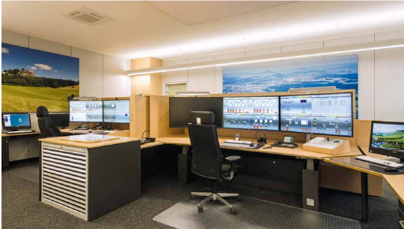
Thüga Energienetze hat ein neues Netzleitsystem eingeführt.
