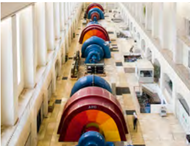
ENGIE Deutschland investiert mehr als zehn Millionen Euro in die Generalüberholung der Kraftwerksgruppe Pfreimd.
