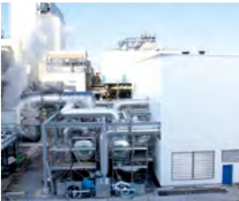
MVV-Fernwärmezentrale: Klimaneutrale Erzeugung geplant.
