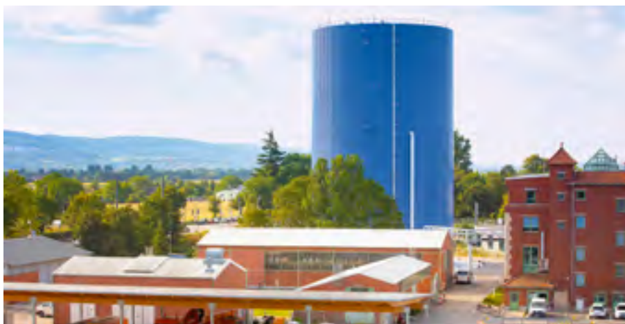
Energiespeicher und Power-to-Heat-Anlagen verwandeln Wind- und Sonnenstrom in Wärme.
