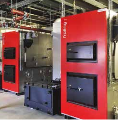
Biomasse-Heizkessel bilden das Rückgrat des Moosburger Versorgungskonzepts.
