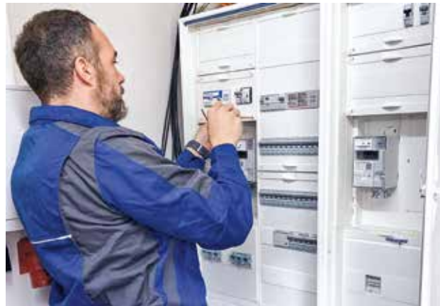
Zählerinstallation für das iMSys.
