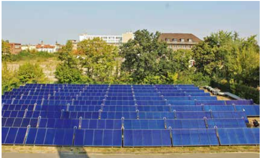
Diese Solarthermieanlage in Berlin dient der Anhebung der Rücklauftemperatur einer Fernwärmetrasse.
