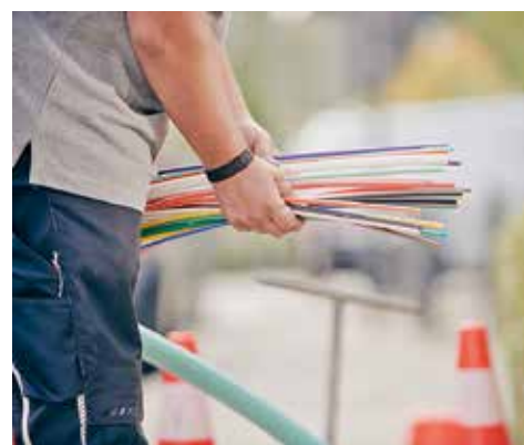
Breitband-Infrastruktur: Übergang von Kupfer zu Glasfaser.
