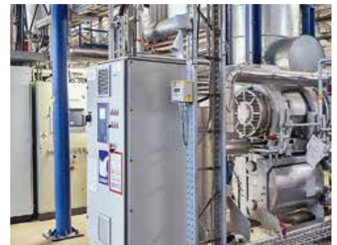
Umweltfreundliche Wärmepumpe im Berliner Heizkraftwerk von Vattenfall.
