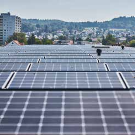
Im Sommer deckt die Photovoltaikanlage einen Großteil des Strombedarfs ab.
