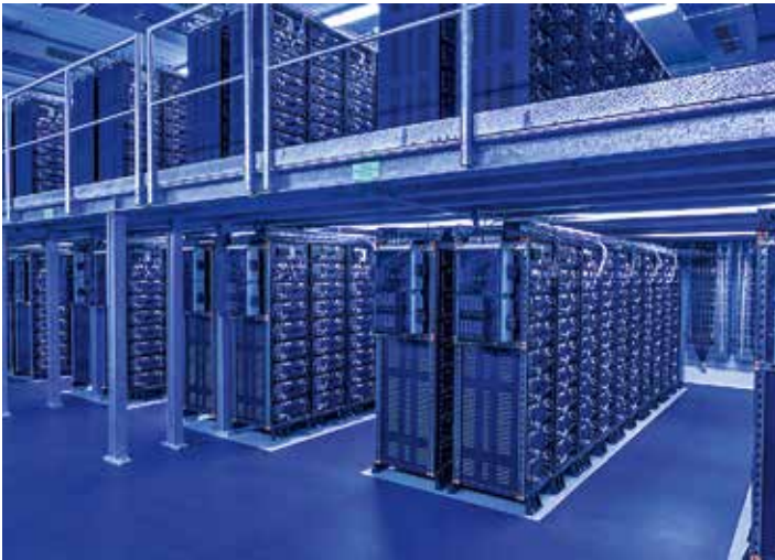
Batteriespeicherkraftwerk von WEMAG erhält Verjüngungskur.
