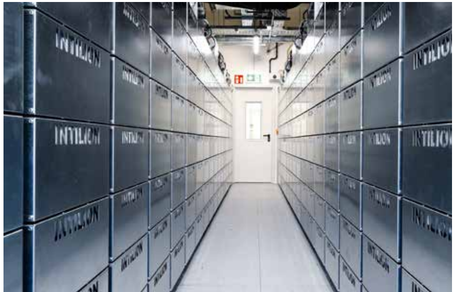
Einer von insgesamt drei Batterieräumen des Megawatt-Hybridspeichers.
