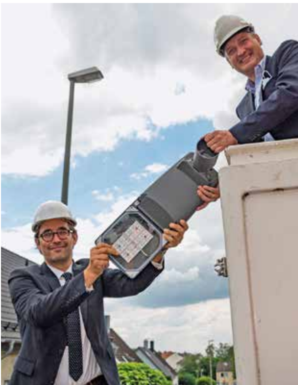
Smarte Leuchten wurden im Wuppertaler Quartier Schöller/Dornap installiert.
